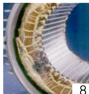
Winding damaged by voltage surge Quema por pico de tensión Verbrannt wegen Spitzenspannung
